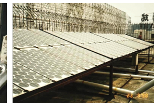
36. Shenzhen - Sinosolar's Rooftop Array
